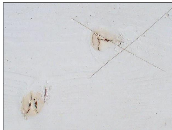
Abb. 2.7: Verfärbungen des Beschichtungssystems durch Holzinhaltsstoffe im Astbereich
