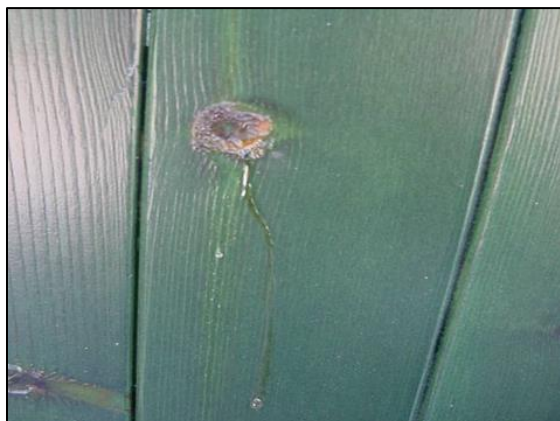
Abb. 2.4: Harzaustritt im Astbereich
