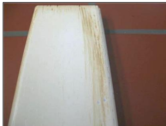
Abb. 2.5: Verfärbung des Beschichtungssystems durch Holzinhaltstoffe
