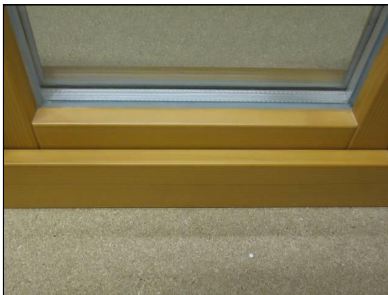
Abb. 4.3: Fenster ohne Bewitterungsschutz
