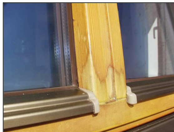
Abb. 4.6: Schäden im Fugenbereich
