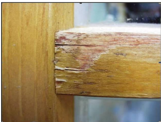
Abb. 4.5: Schäden im Fugenbereich
